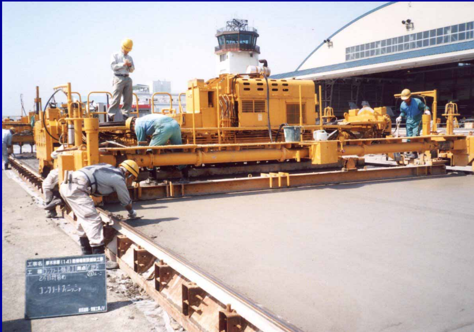
セツトフォーム工法による普通コンクリート版施工状況
