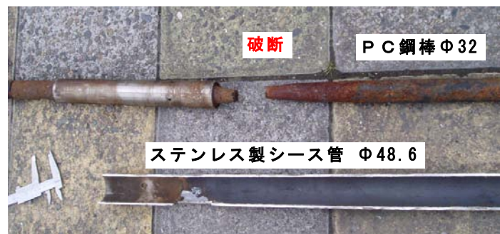
[保護管内部の浸水でPC鋼棒が腐食し破断]
