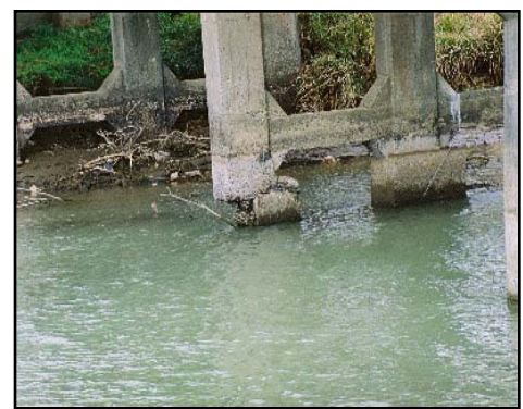
[ 洗掘によって破壊された橋脚 ]
