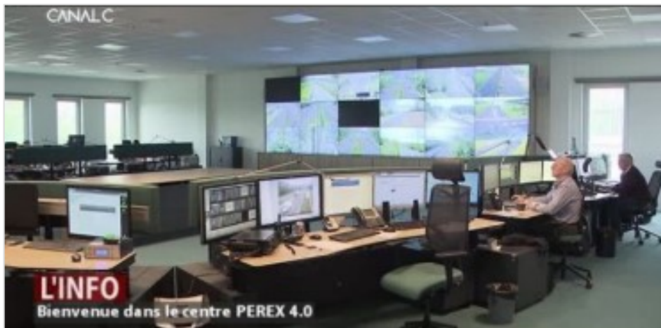
図 5.11: パンデミック中における交通管制センターの活用
