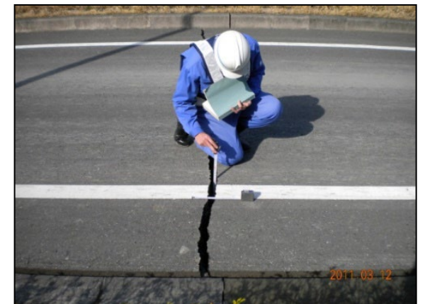
被災箇所の確認
