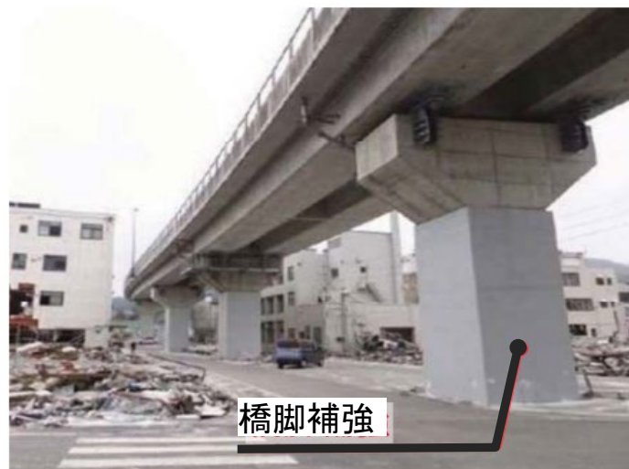
国道45号(観測震度：震度6弱)
