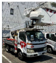
倒壊電柱・電線除却 (東京電力パワーグリッド)
