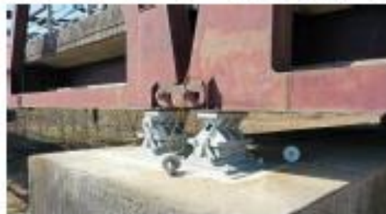
P3支承(可動):ピンの脱落
