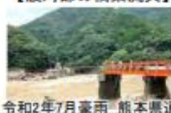
令和2年7月豪雨、熊本県道
