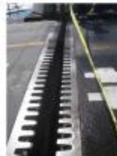
A1橋台上の伸縮装置の開き 横軸方向:約40cm 縦軸直角方向:約20cm
