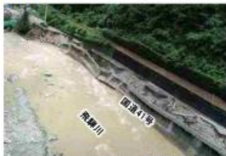
令和2年7月豪雨 国道41号
