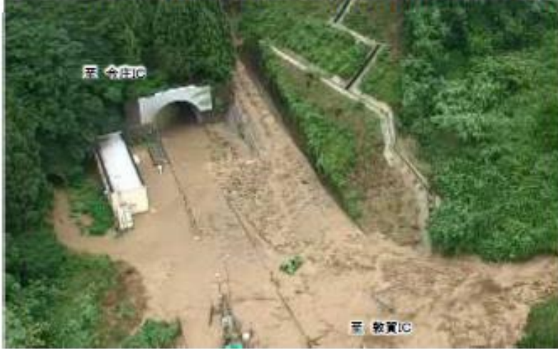
【トンネル坑口部における土砂の大規模流入:令和4年8月の大雨(E8北陸自動車道)】
