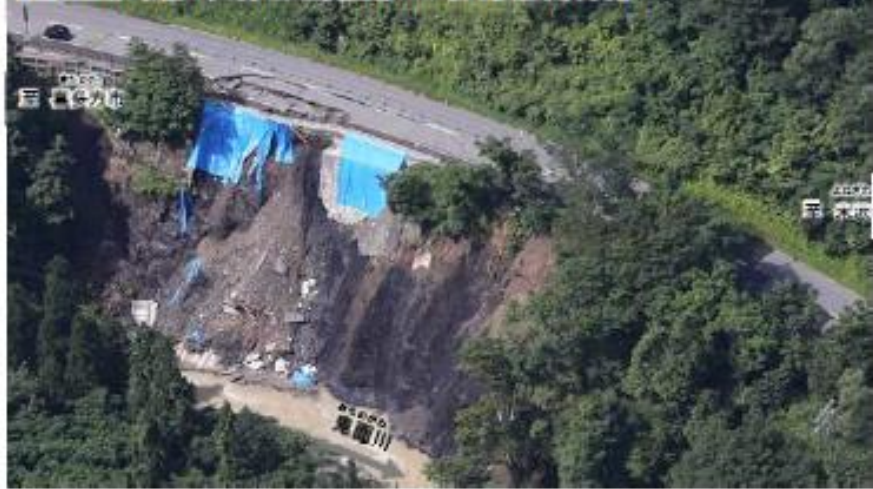
【道路崩落:令和4年8月の大雨(国道121号山形県米沢市)】
