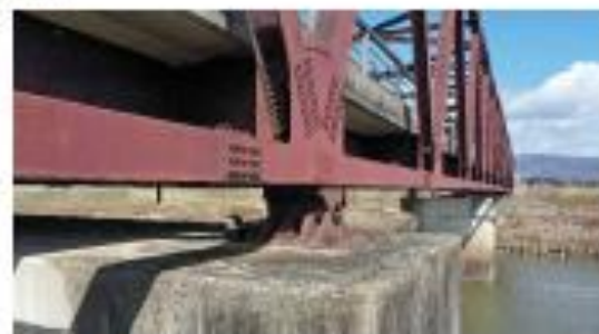
P2支承(固定):ピンの脱落
