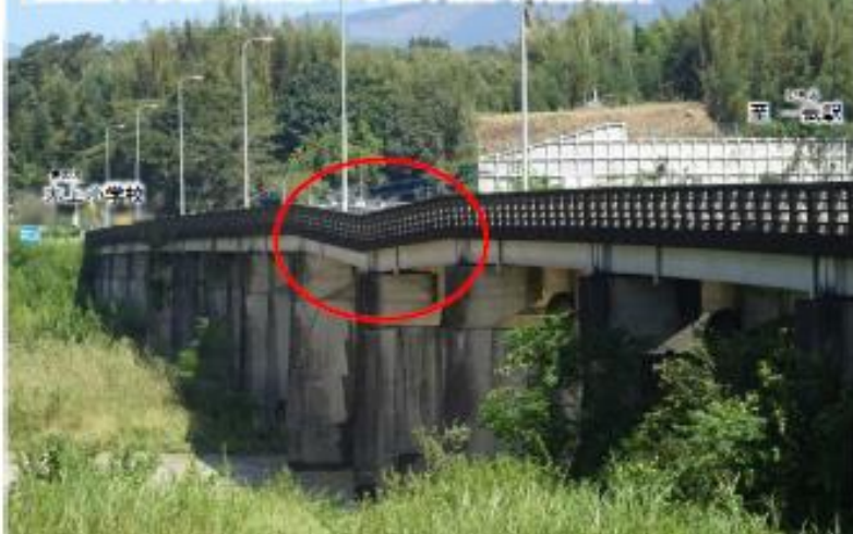
【橋梁沈下:令和4年台風第14号(熊本県錦町球磨大橋)】
