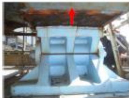
P2支承(固定): 下弦材と上桁の間の溶接が外れ上部構造が移動
