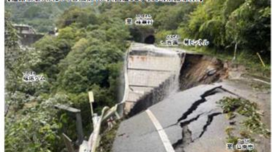
【道路崩壊:令和4年台風第14号(国道327号宮崎県諸塚村)】
