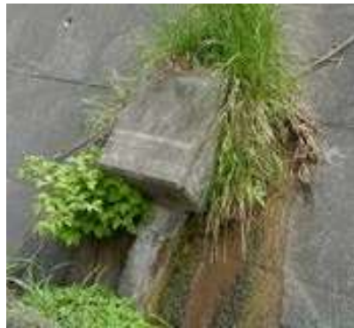
アンカーの頭部からの湧水雑草の繁茂の例
