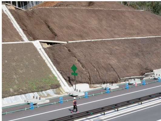
■ 国道483号日高豊岡南道路:切土部 令和3年3月18日発生(令和2年(2020年)11月開通) ※ 施工中に、近傍(約200m)で被災した事象あり
