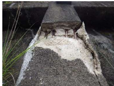
法枠工の老朽化損傷
