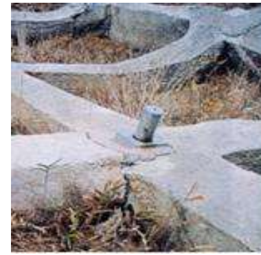
受圧構造物の破損の例
