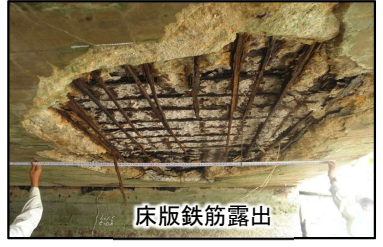
【橋梁の老朽化事例】
