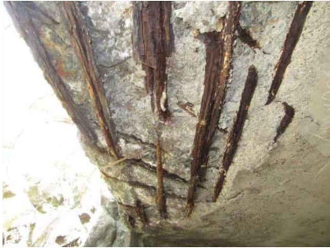
国管理 床版鉄筋露出
