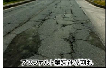
【舗装の老朽化事例】
