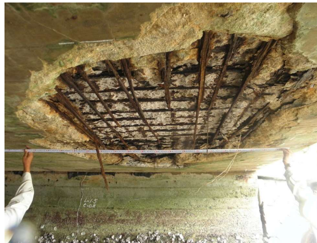
地方自治体管理 床版鉄筋露出
