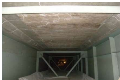
ひび割れの発生
