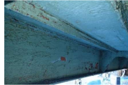
桁の塗装劣化やさびの発生
