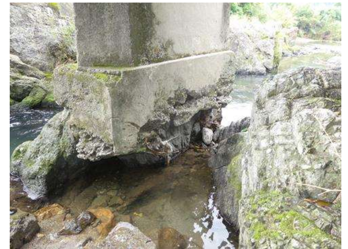
地方自治体管理 橋脚洗掘
