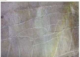
下部工のひび割れ
