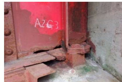
桁端部の腐食・貫通
