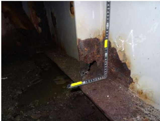
国管理 主桁腐食・欠損
