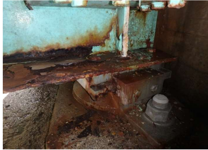
地方自治体管理 主桁腐食
