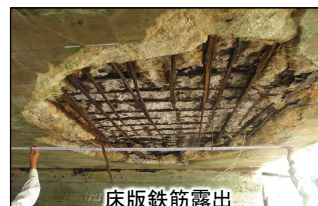
【橋梁の老朽化事例】
