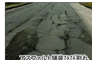
【舗装の老朽化事例】
