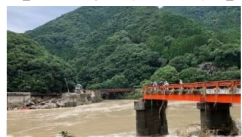
【渡河部の橋梁流失】
