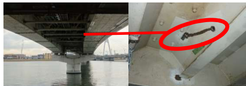
縦リブ等に多数の疲労亀裂が発生
