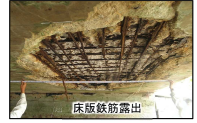
【橋梁の老朽化事例】
