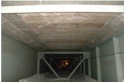
ひび割れの発生
