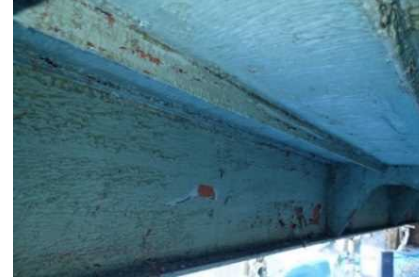
桁の塗装劣化やさびの発生
