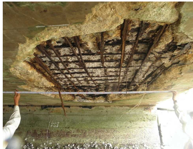
地方自治体管理 床版鉄筋露出
