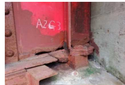
桁端部の腐食・貫通
