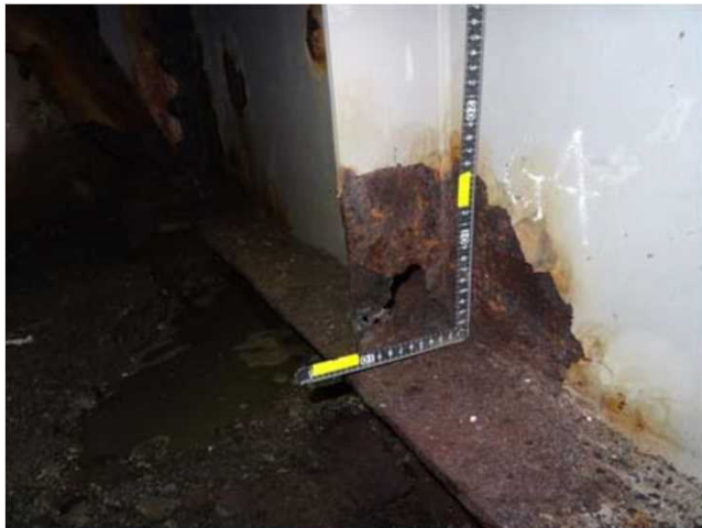
国管理 主桁腐食・欠損
