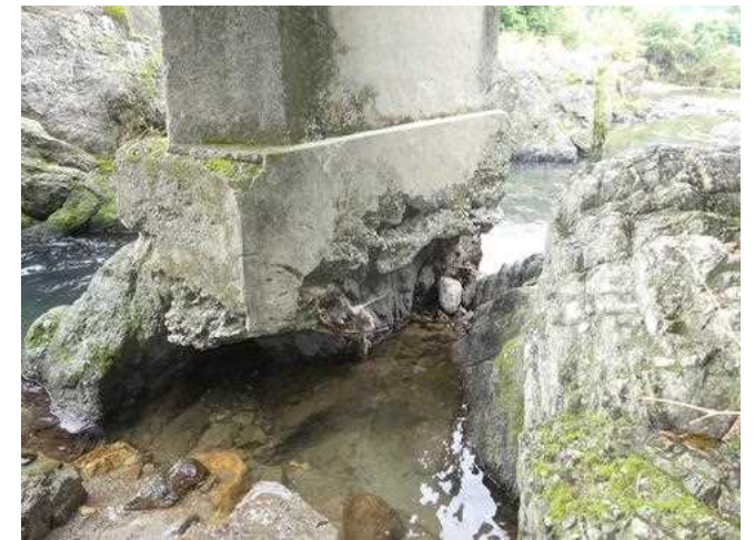
地方自治体管理 橋脚洗掘
