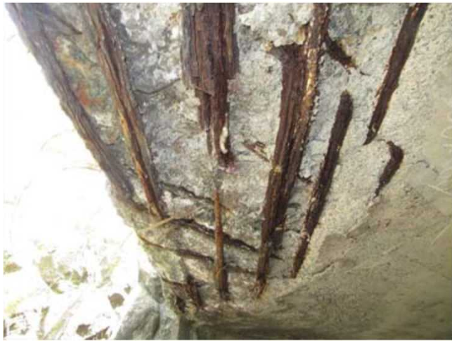
国管理 床版鉄筋露出
