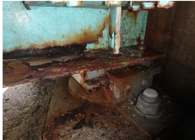
地方自治体管理 主桁腐食
