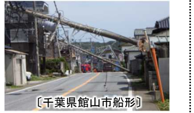
【台風等による電柱倒壊状況】
