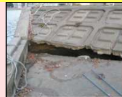
クラックが生じた河川護岸 早期に措置が必要な施設の例
