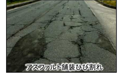
【舗装の老朽化事例】
