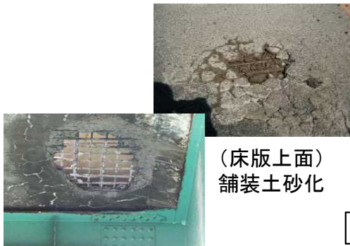
(床版下面) 床版の抜け落ち
