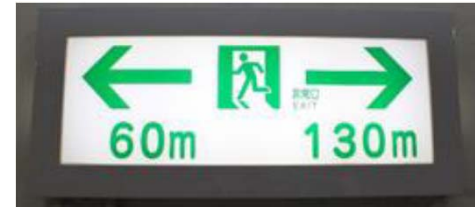
誘導表示設備(内照式)
