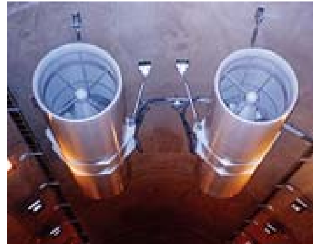
排煙設備(ジェットファン)
