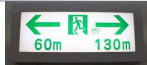
誘導表示設備(内照式)
