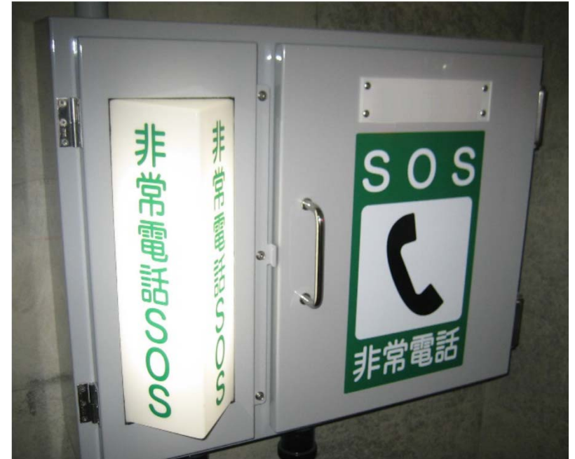
解説写真 - 4.2 非常電話の設置の例(壁掛型)
