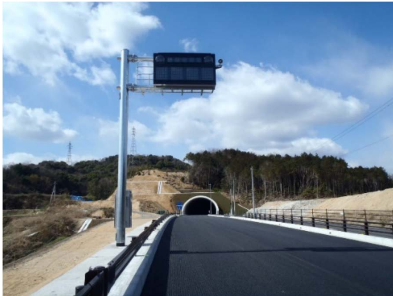
警報表示装置の設置位置の例：坑口手前に設置
