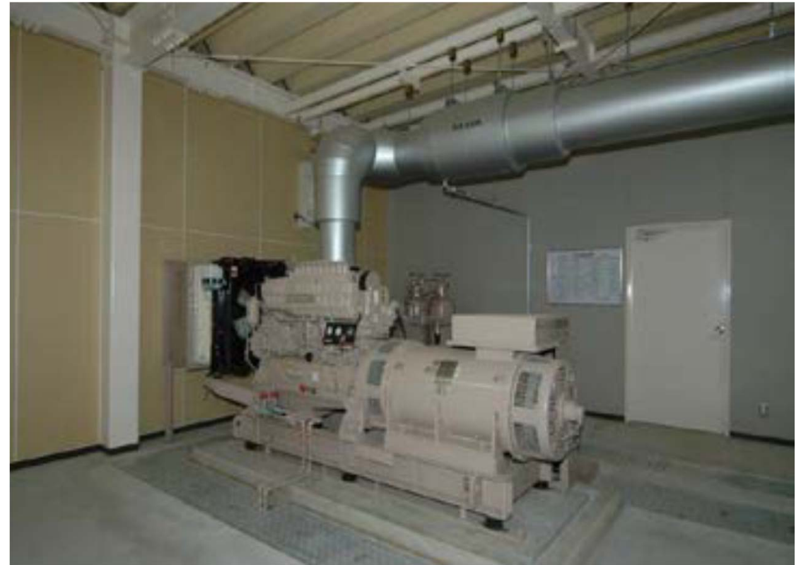
予備発電設備装置(ディーゼルエンジン発電装置)
