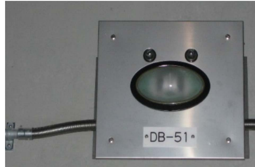
自動通報設備 (火災検知器:二波長式ちらつき型火災検知器)
