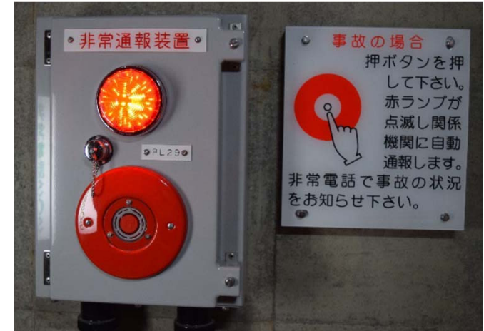
操作型通報設備(押ボタン式通報設備)
