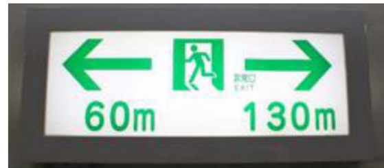
誘導表示設備(内照式)
