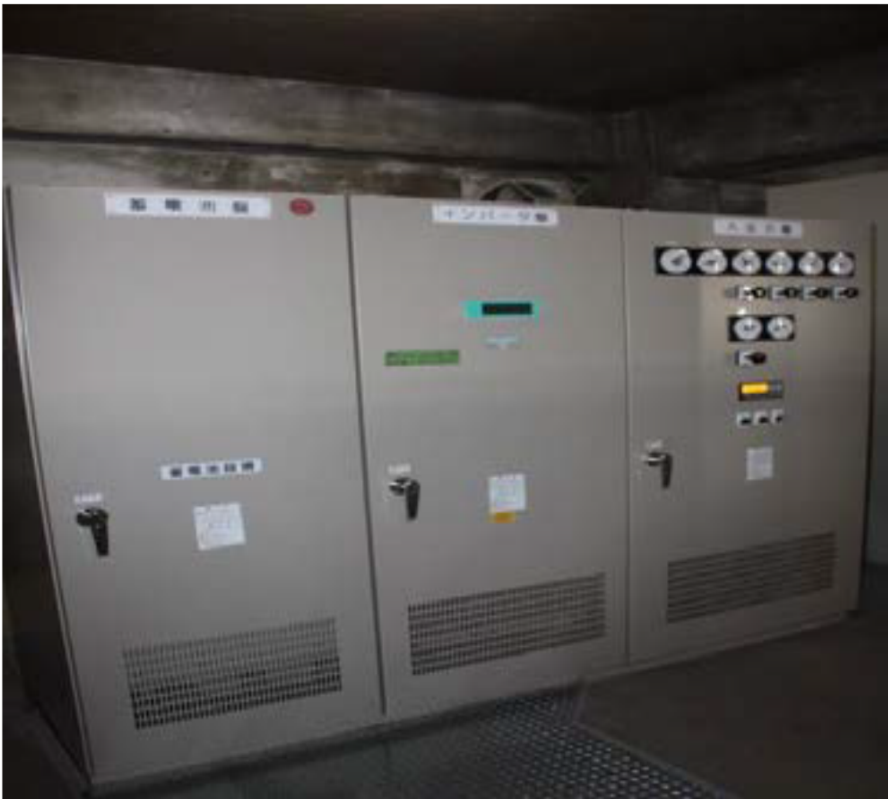
無停電電源装置
