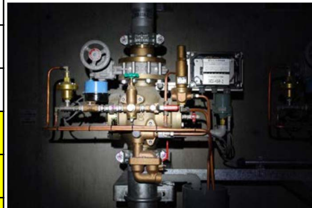
水噴霧設備 (自動弁装置)
