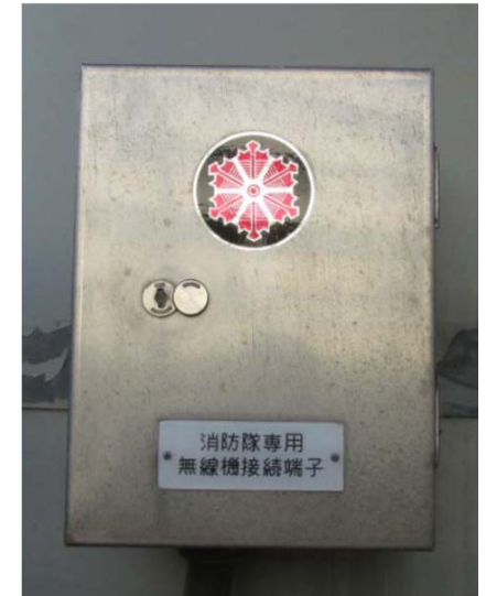
無線通信補助設備 (無線機端子箱)
