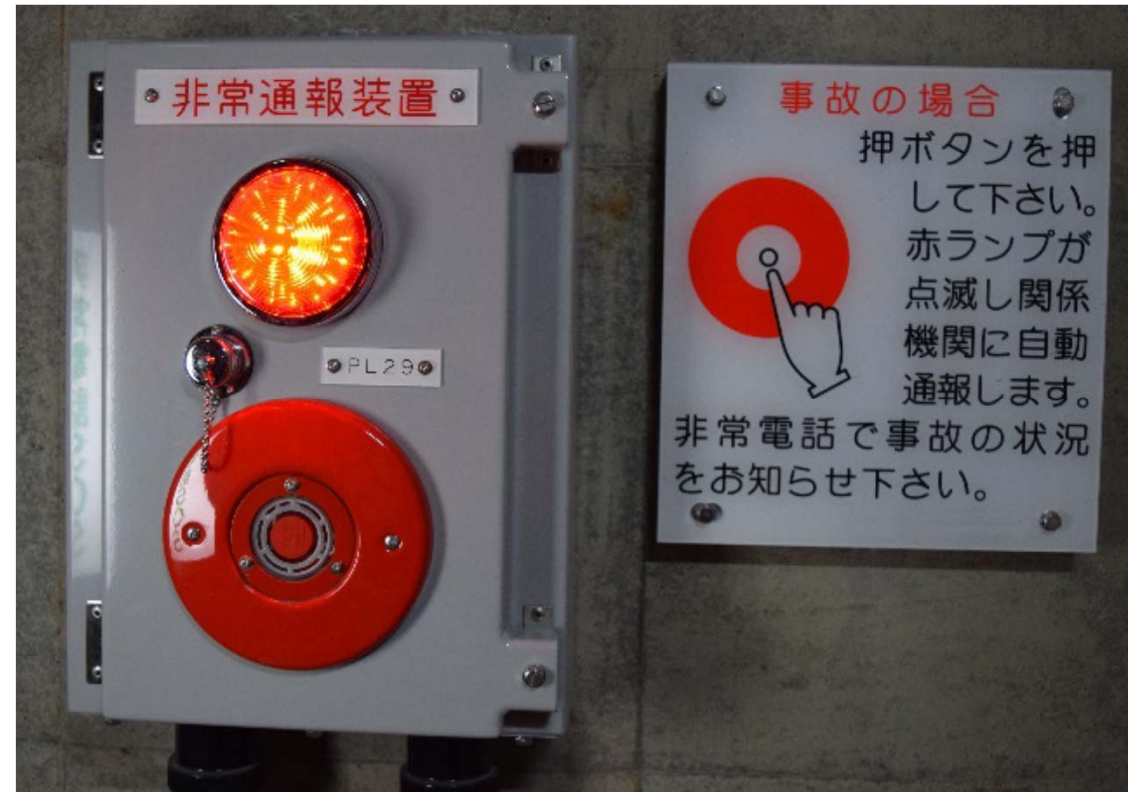
操作型通報設備(押ボタン式通報設備)
