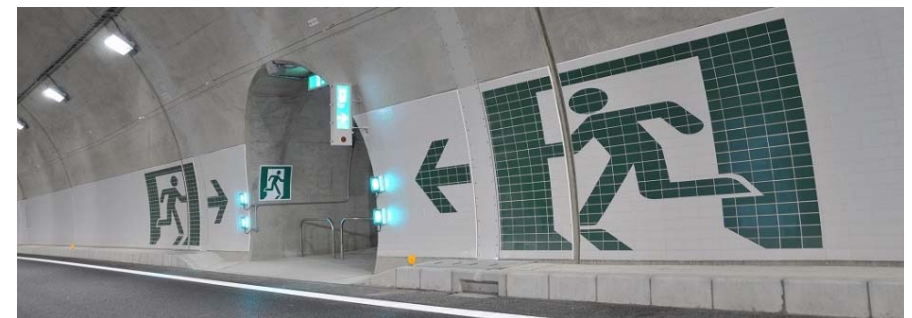
大型の誘導表示設備
