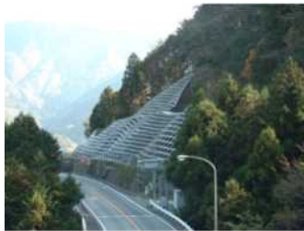
&lt;のり面防災対策&gt;
