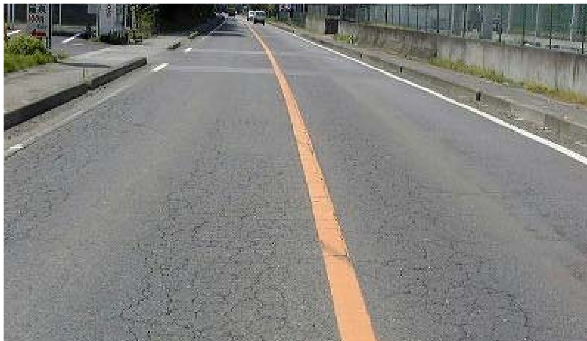
路床・路盤の支持力低下による亀甲状ひび割れの例
