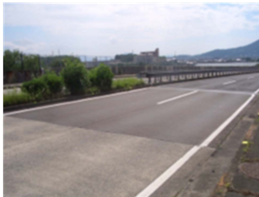
踏掛版とコンクリート版との境目の段差の例
