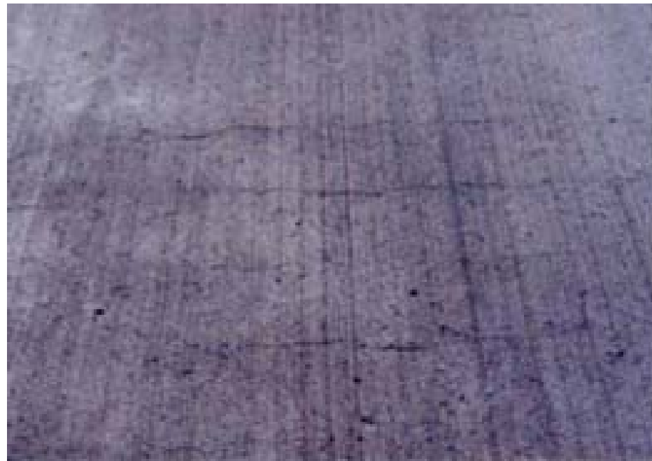
コンクリート舗装版に生じた沈下ひび割れの例
