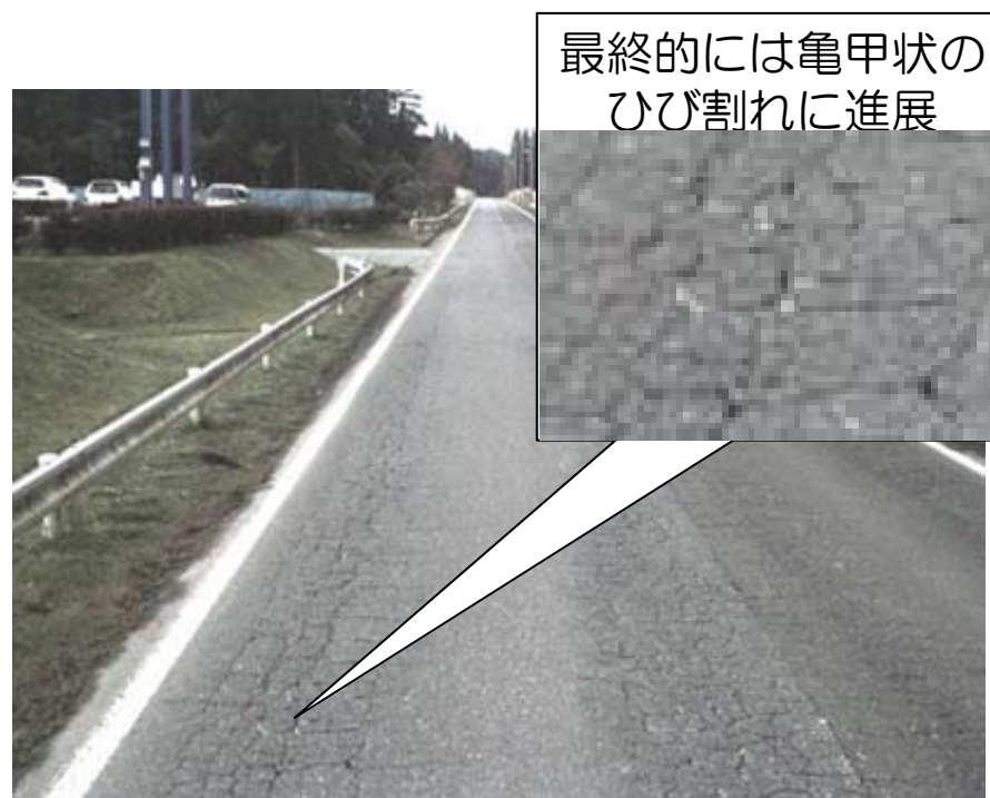
疲労ひび割れ(終期)の例
