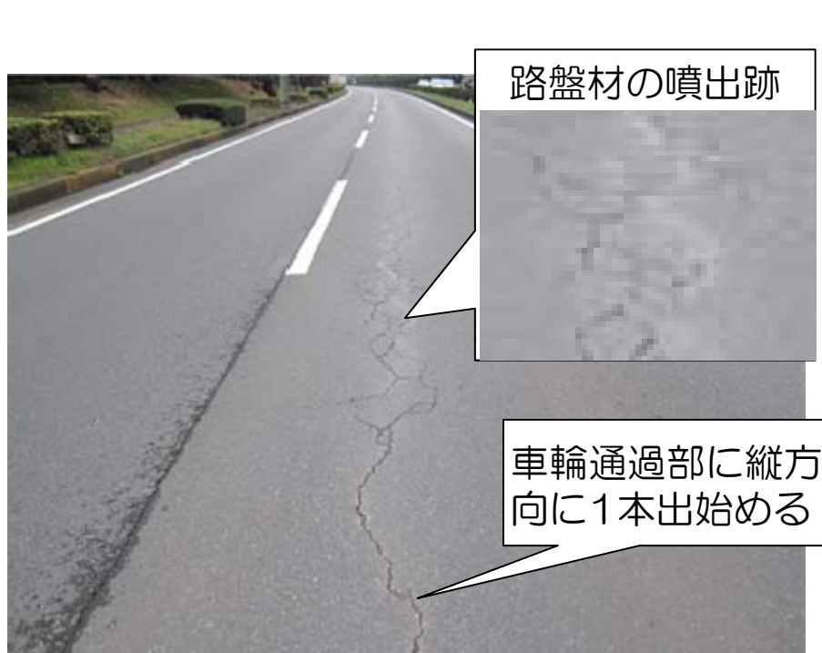
疲労ひび割れ(初期)の例
