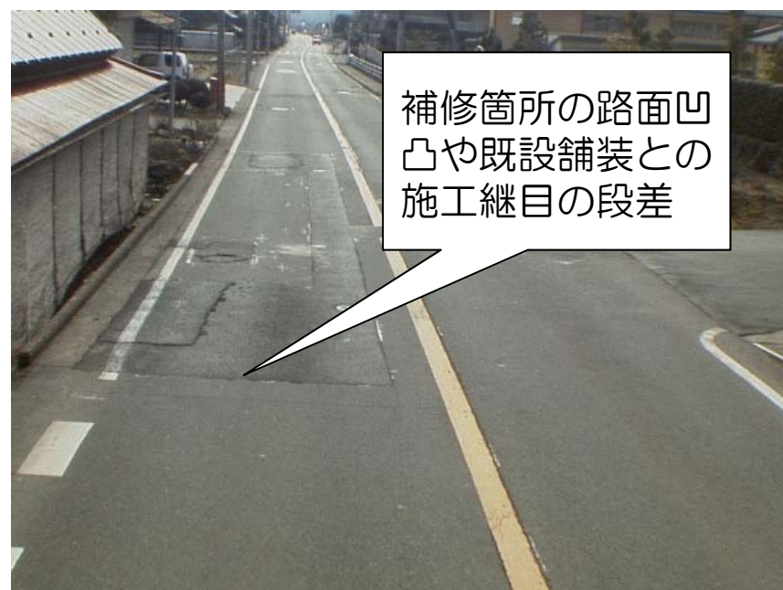
補修箇所の路面による縦断方向の凹凸
