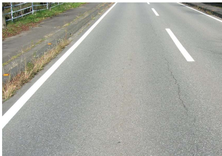
ひび割れ率 5%程度の例
