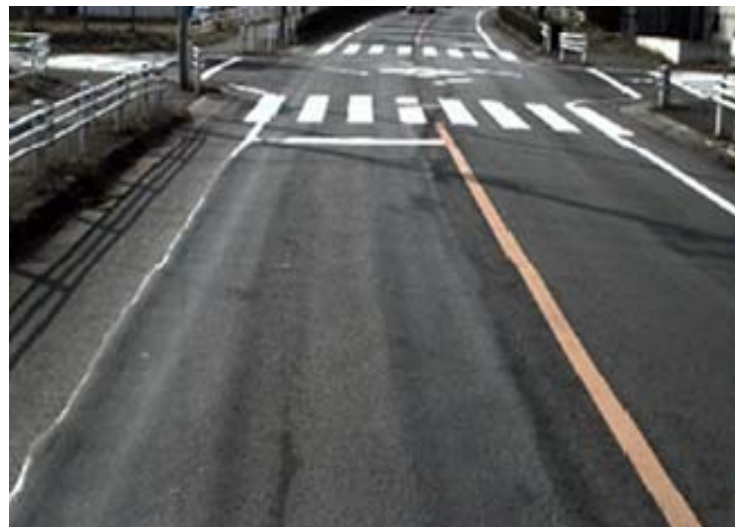
わだち掘れ量30mm程度の例
