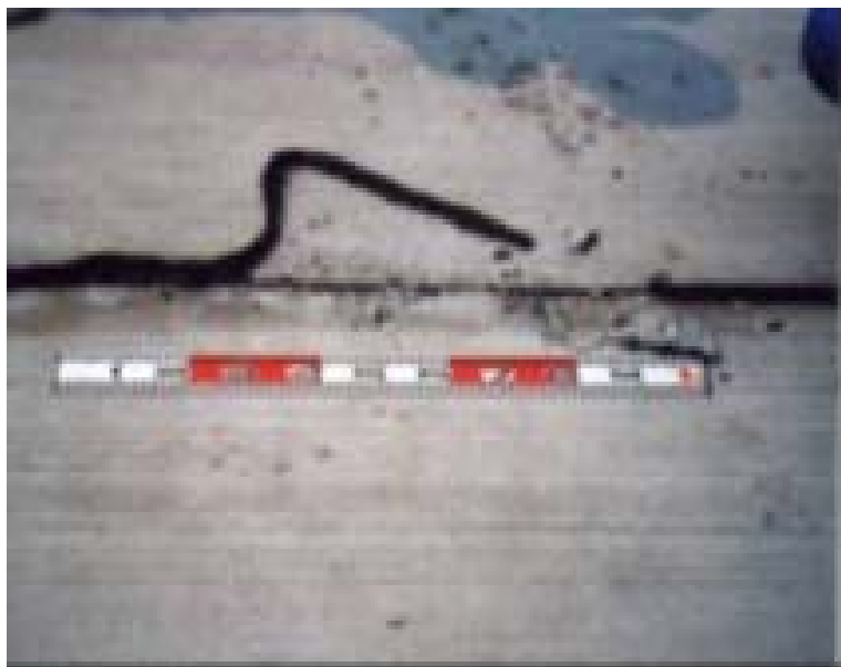
目地材のはみ出し、飛散の例
