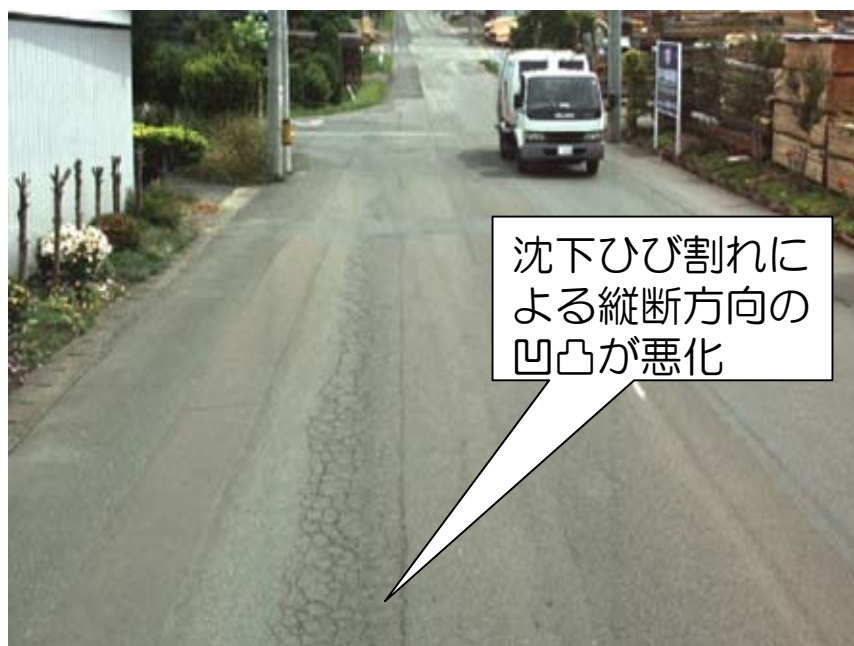
沈下ひび割れによる縦断方向の凹凸 (抜粋)
