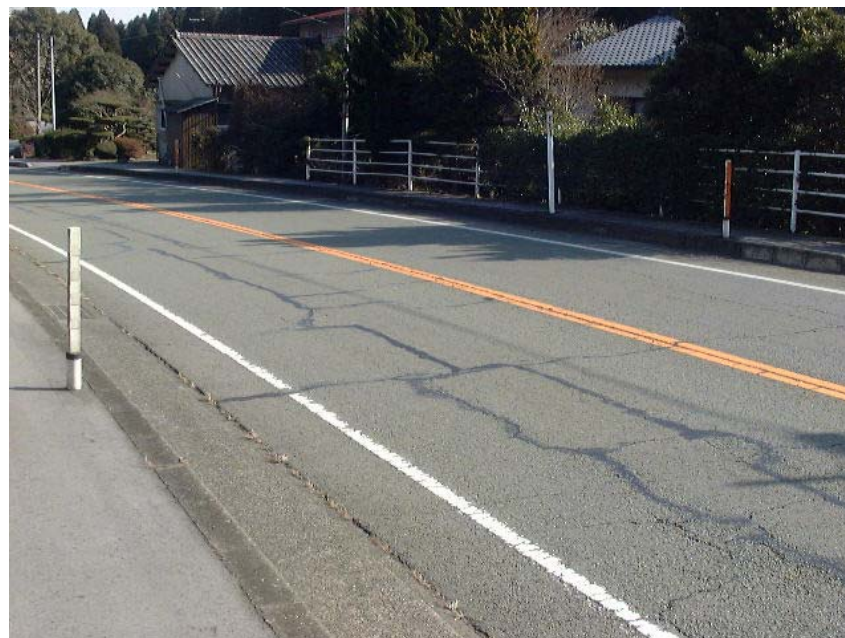
縦断方向に発生した例
