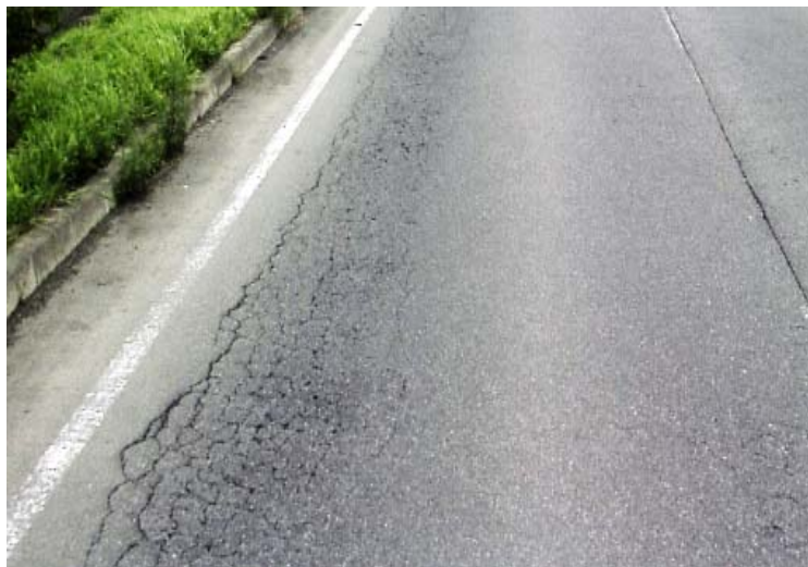
ひび割れ率 35%程度の例
