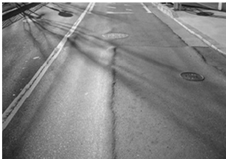
わだち掘れ量40mm程度の例
