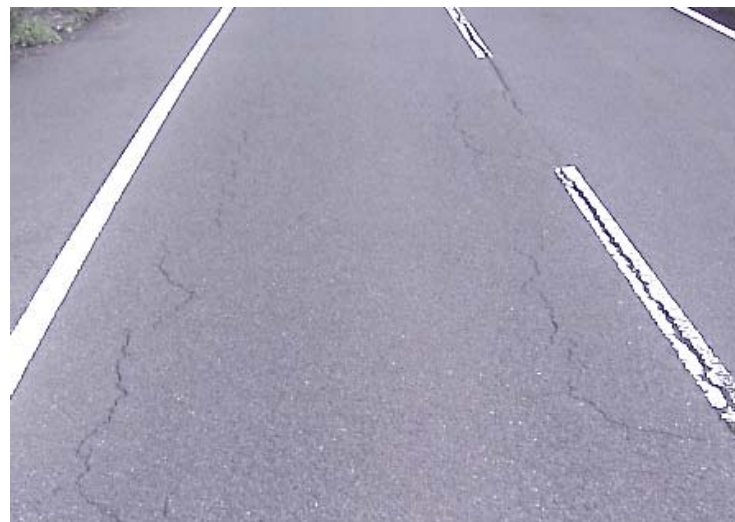
ひび割れ率 20%程度の例
