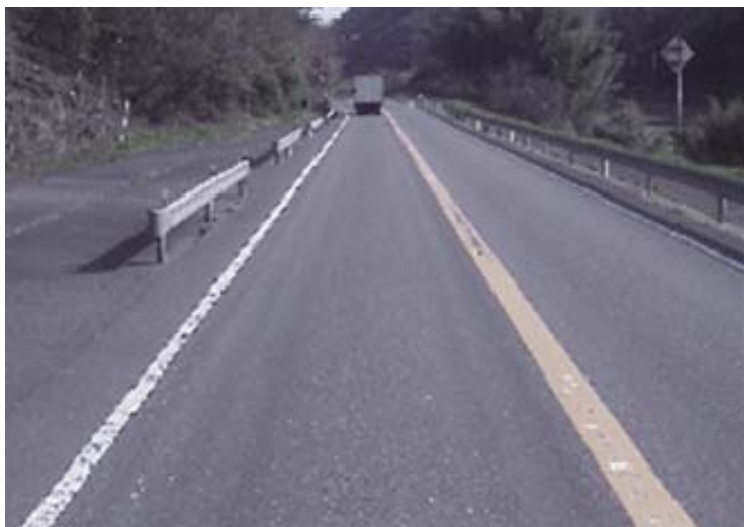
わだち掘れ量15mm程度の例
