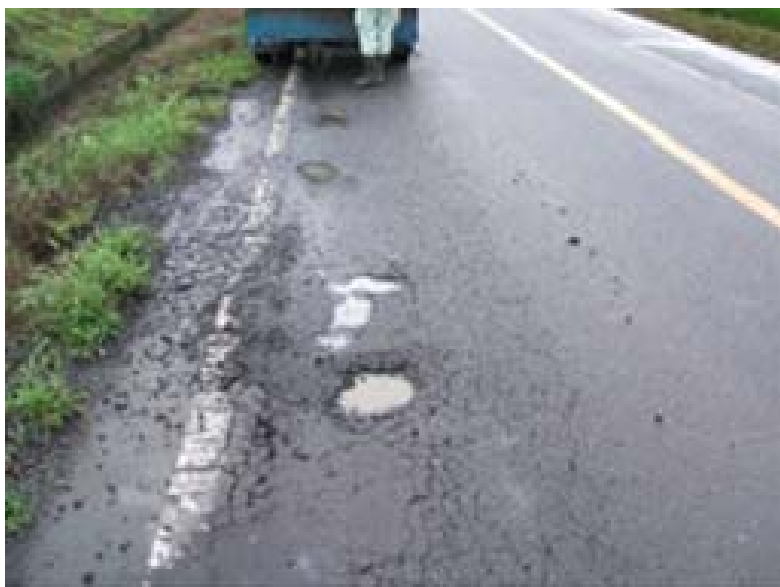
ポットホールの例
