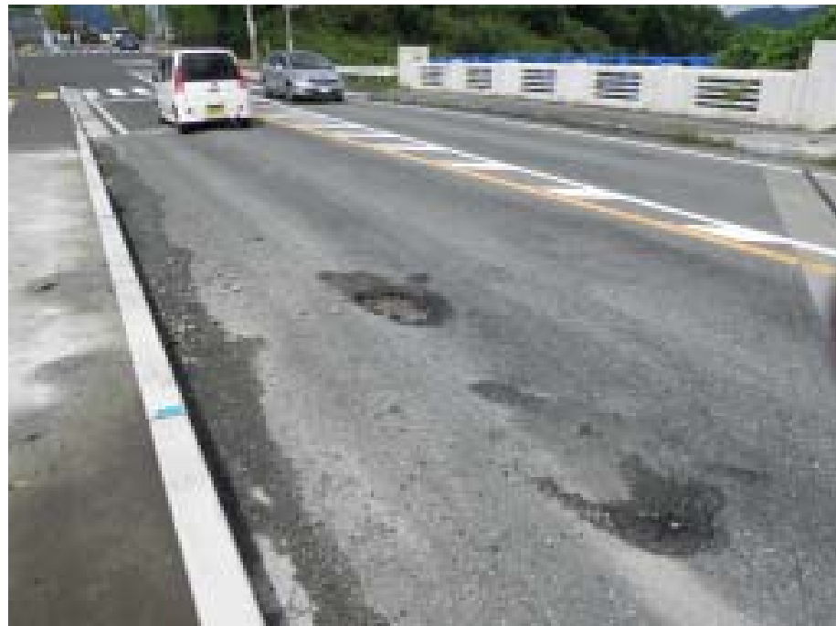
ポットホールの例
