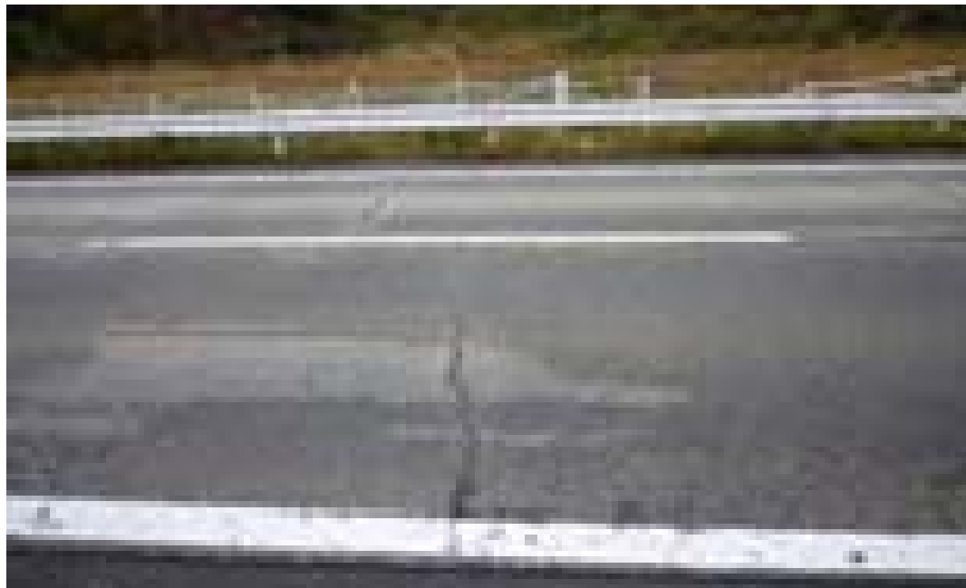
普通コンクリート舗装の横ひび割れの例
