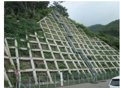
点検用通路を設置した事例
