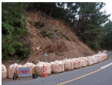
奄美大島豪雨による切土法面崩落 →復旧に3日(H22.10 奄美市)
