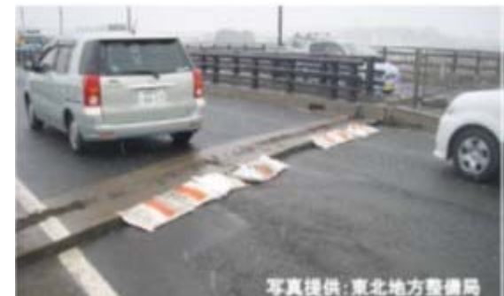
橋梁取り付け部の不等沈下による段差 (国道4号 宮城県大崎市)
