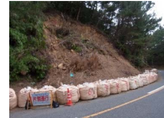
奄美大島豪雨による切土法面崩落 → 復旧に3日(H22.10 奄美市)
