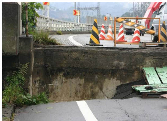
橋梁取り付け部の盛土の崩落 (国道117号 新潟県小千谷市)
