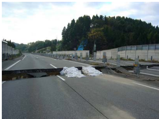
ボックスカルバート取り付け部の盛土の段差 (関越道 小千谷IC～越後川口IC)
