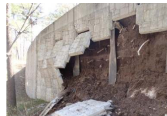
補強土壁の壁面パネル落下(H25.4) → 片側交互規制、大型車通行止め → 1年以上経過後も復旧できず
