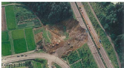
台風の大雨による 盛土法面崩落(H11.8) → 地下排水構造物の分断が一因 復旧に1ヶ月
