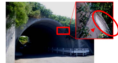
不同沈下による躯体の亀裂損傷(H23.11) → 現在、経過観察中 → 修復方法が確定できていない
