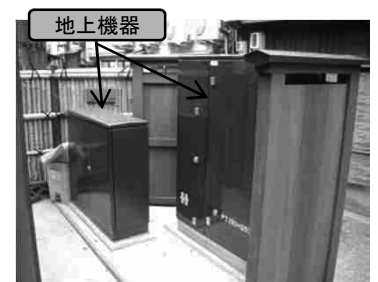
民地を活用した地上機器の設置
