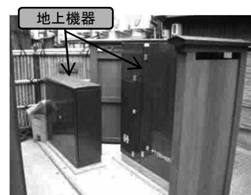
民地を活用した地上機器の設置
