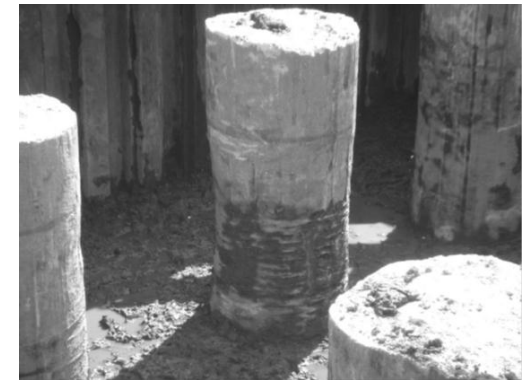
場所打ち杭の細りの事例
