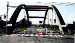
路面をついている鋼材1本が破断し、通行止めになった千葉県君津市内の市道橋
