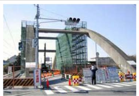
PC鋼棒が破断し対策工事を実施している君津新橋=君津市で
